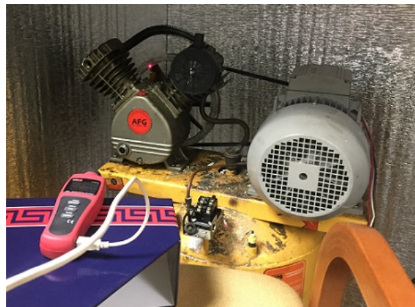
Figure 11 Medición de velocidad en el sistema de aire comprimido con motor trifásico.
