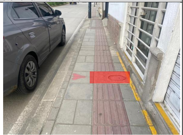
Falta de continuidad en la franja guia para personas en condicion de discapacidad
