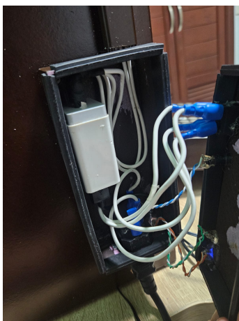
(a) Vista interna de la caja eléctrica del prototipo.
