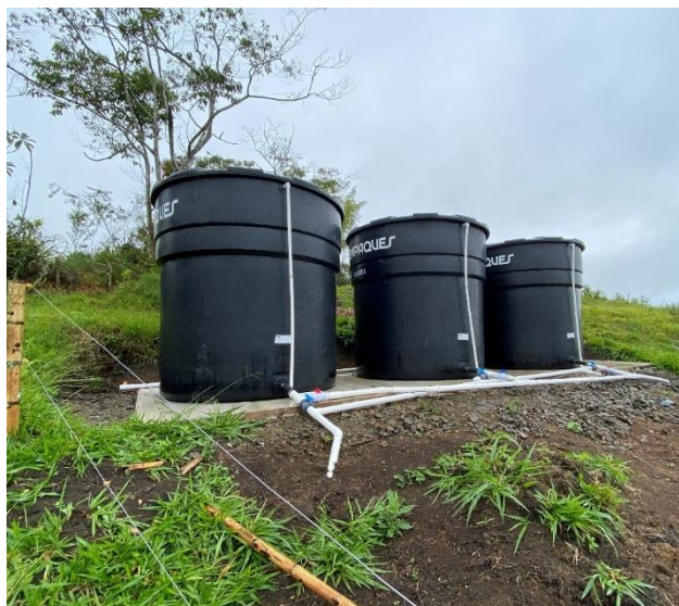
Figura 2. Tanques de almacenamiento del sistema actual.
