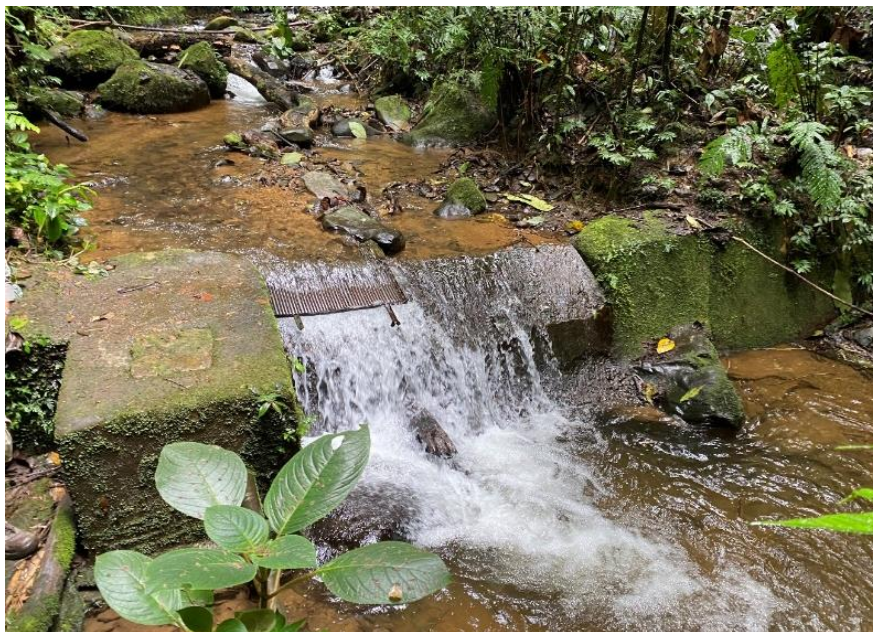
Figura 3. Bocatoma del sistema actual.
