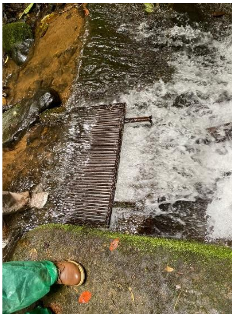
Figura 10. Rejilla en bocatoma de fondo
