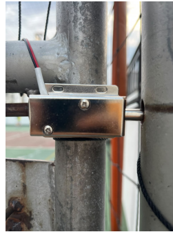
Figura 7.2: Verificación de la cerradura electrónica durante la prueba funcional.
