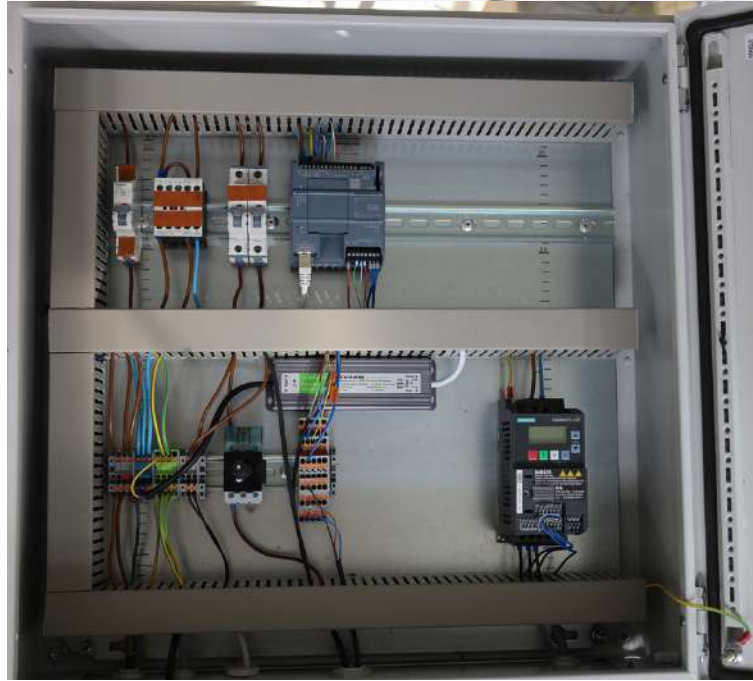
Figura 48. Gabinete eléctrico. Fuente: Elaboración propia.
