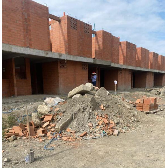
Figura 15. Acopio de residuos en los frentes de las viviendas
