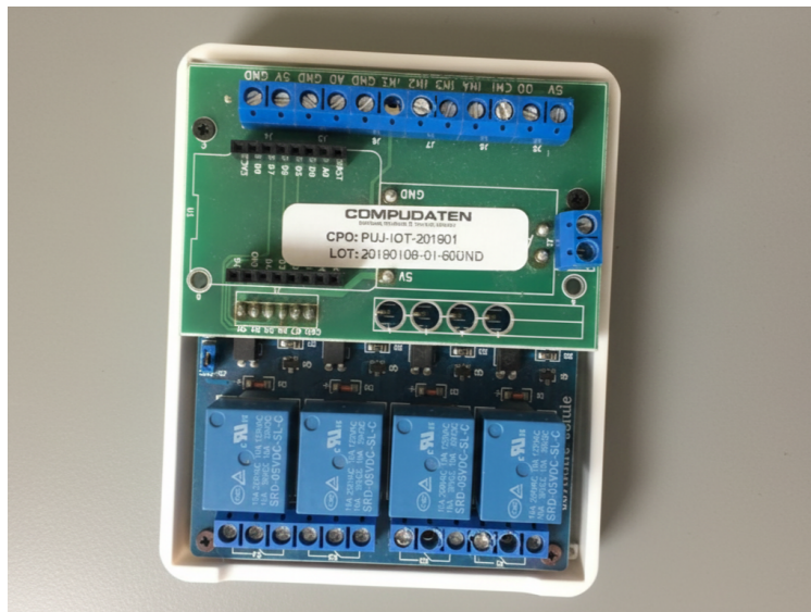
Figura 6.14: Módulo de actuación basado en ESP8266 y relés, ensamblado e instalado en aula (fotografía real).
