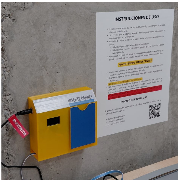
Figura 6.10: Ubicación del nodo RFID en el aula y condición de montaje durante operación (fotografía real).
