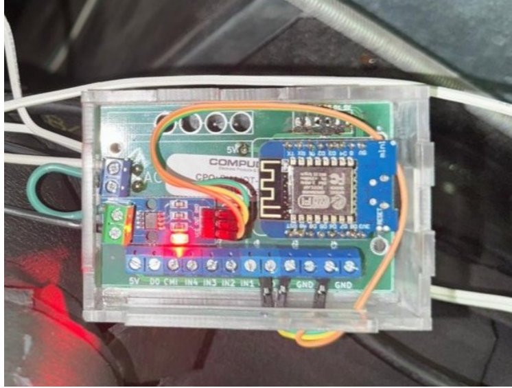
Figura 6.12: Nodo de medición de corriente con sensor ACS712-20A instalado en el aula (fotografía real).
