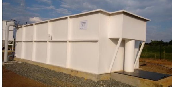
Figura 22. Tanque de contacto de cloro
