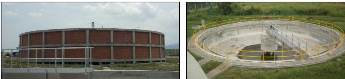
Figura 35. Filtro percolador (izq.) y sedimentador secundario (der.)
