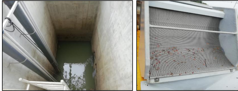
Figura 16. Pozo de bombeo (izq.) y Tamiz estático (der.)
