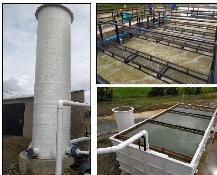
Figura 14. Columna de lodos (izq.); Tanque de aireación (arriba); Sedimentador secundario (abajo)
