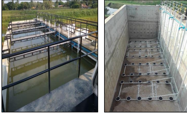
Figura 20. Tanque de aireación vista superior e interior
