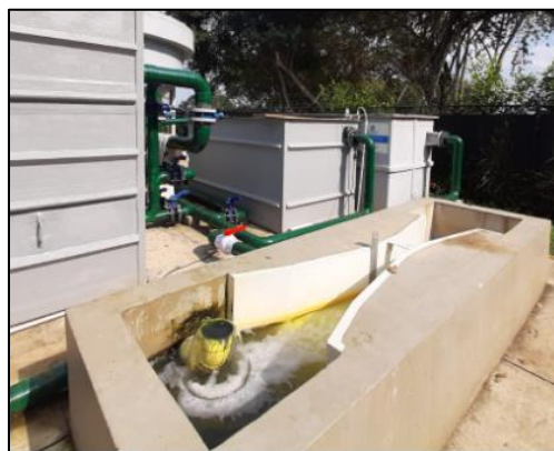
Figura 25. Canaleta parshall y Tanques de contacto de cloro al fondo
