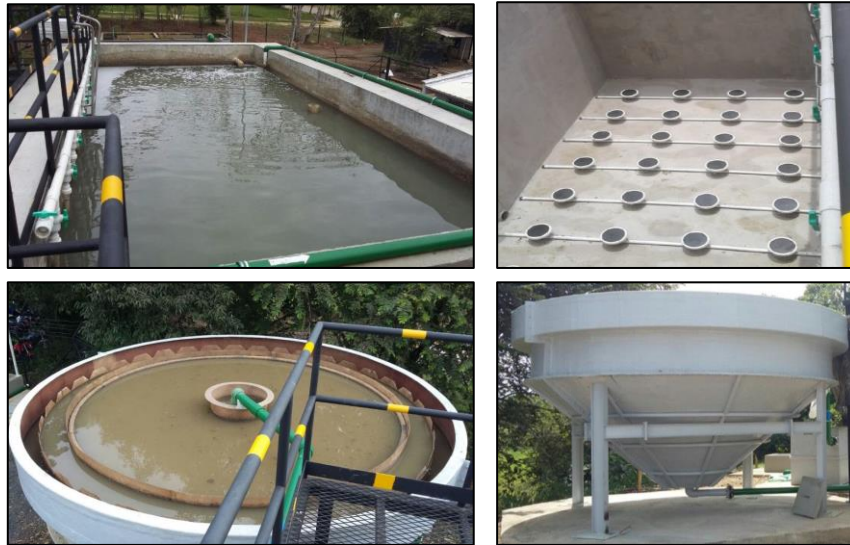
Figura 24. Tanque de aireación (arriba.) y Sedimentador secundario (abajo.)
