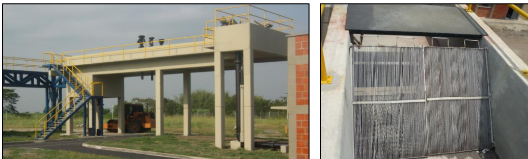
Figura 34. Estructura tratamiento preliminar: Desarenador y rejillas finas
