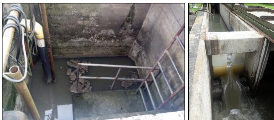
Figura 29. Tanque bombeo No.1 (izq.); desarenador (der.)
