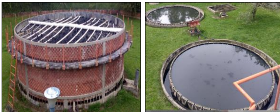
Figura 31. Filtro percolador (izq.); decantadores secundarios (der.)
