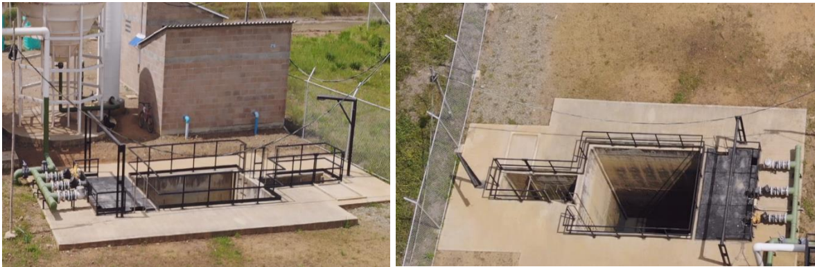
Figura 11. Canal de desbaste, Trampa de grasas, Pozo de bombeo
