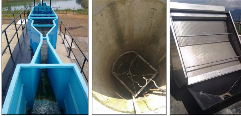
Figura 19. Estructuras del pretratamiento: Canastilla en pozo de inspección (izq.); canal de cribado y aforo (centro); Tamiz estático (der.)
