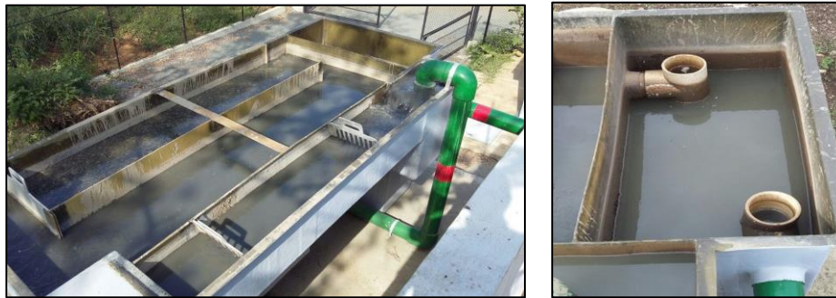
Figura 23. Tanque de tratamiento preliminar (izq.); Trampa de grasas (der.)
