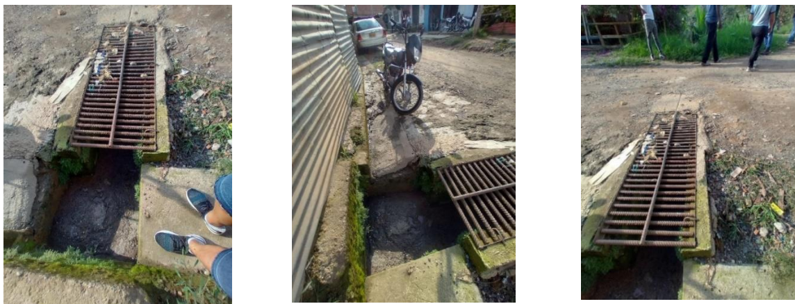
Figura: 6 Alcantarillado incipiente
