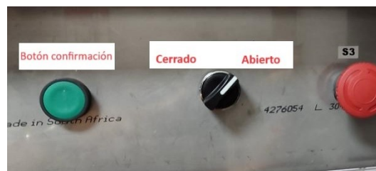
Figura 8.23: Elementos de interacción en el panel eléctrico
