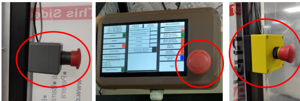
Figura 8.26: Botones de emergencia instalados en parte exterior, teach pendant y dentro de zona de peligro, respectivamente.
