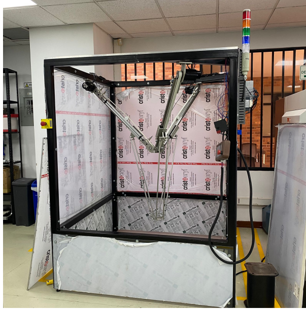
Figura 8.22: Proceso de instalación de guardas de seguridad
