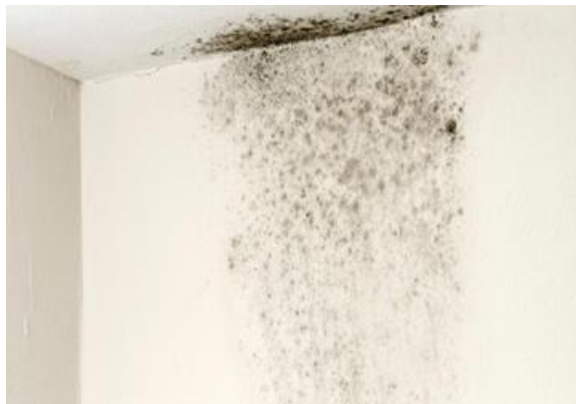
Figura 5. Humedad en techos y paredes
