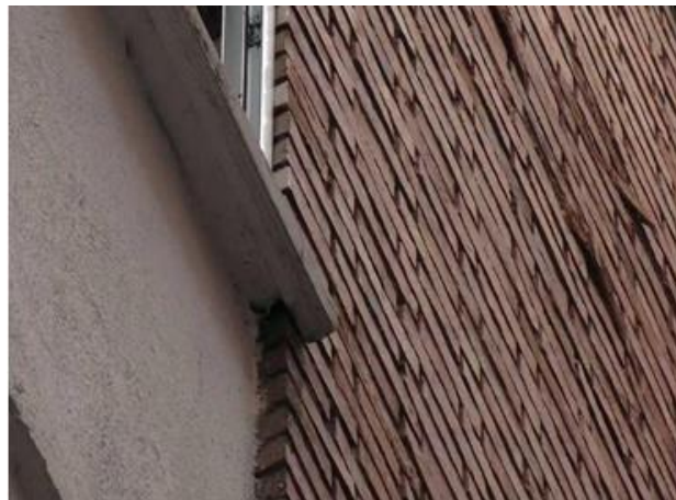
Figura 9. Desprendimiento fachaletas en ladrillo
