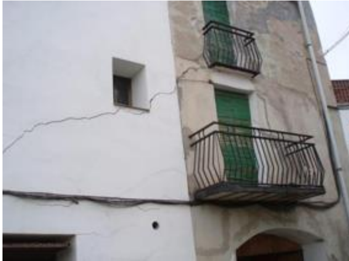
Figura 7. Fisuras y grietas estructurales en edificios
