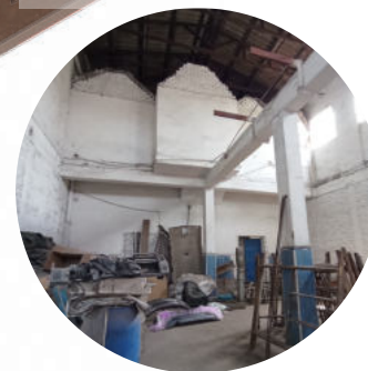
Técnicas constructivas fuera de norma (Derribo)
