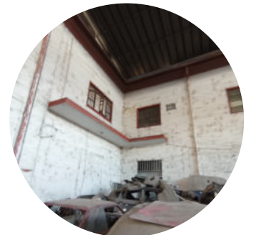
Elementos añadidos que no corresponden con el estilo original (Derribo)
