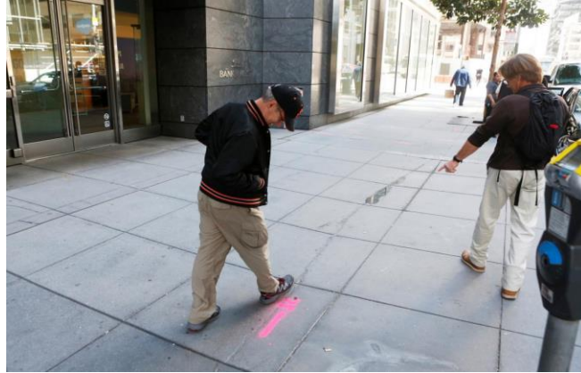
Figura 10. Fisuras por asentamientos en vía pública contigua a la edificación Millenium Tower.
