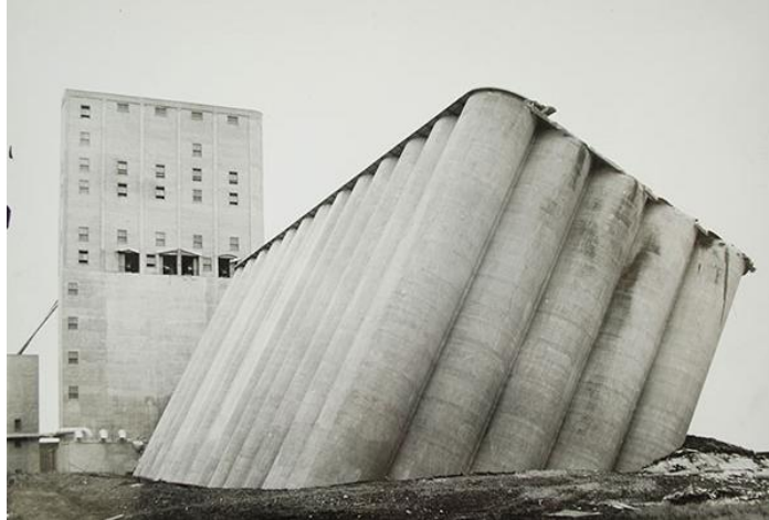
Figura 4. Hundimiento de los silos de Transcona, Manitoba
