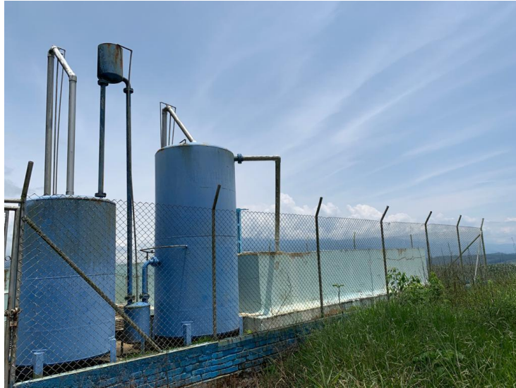
Figura 6. Tanques fuera de servicio y tanque principal de almacenamiento.
