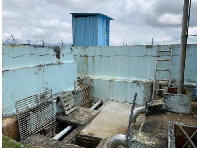
Figura 19. Detalle de los dos tanques principales de almacenamiento y caseta de tratamiento.
