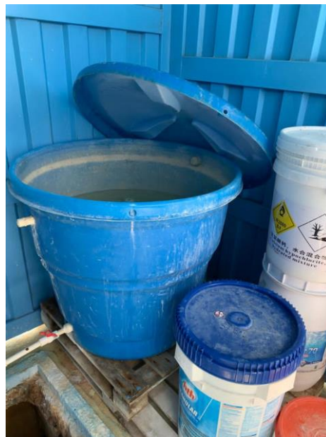
Figura 16. Dosificación de cloro al 70%.
