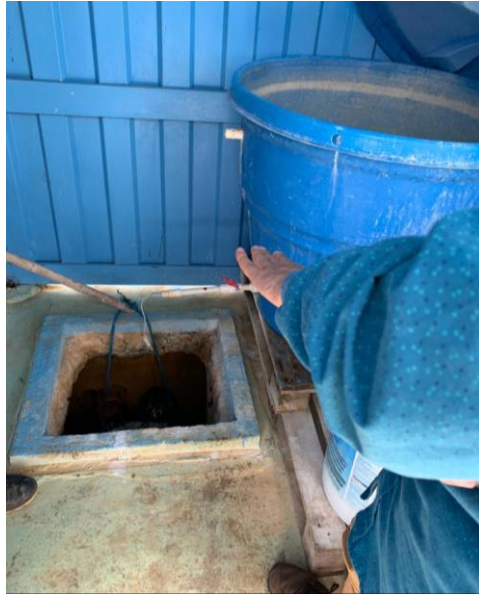
Figura 15. Punto de cloración del agua.
