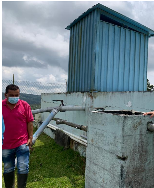
Figura 13. Centro de cloración y tuberías de abastecimiento de las quebradas Sinaí y Calimitas.
