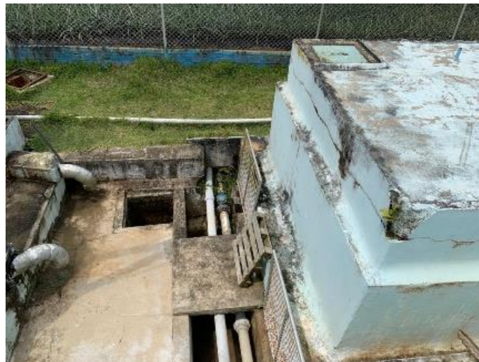
Figura 18. Tuberías de distribución del tanque principal.
