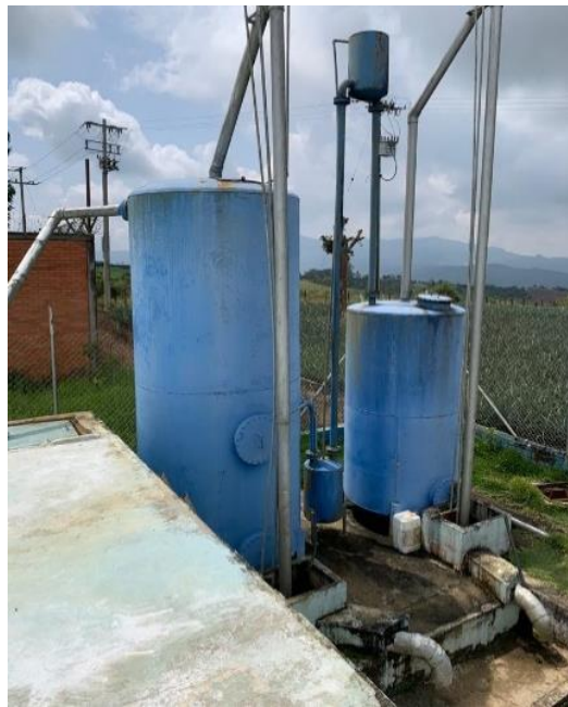
Figura 5. Tanque de potabilización de agua compacta fuera de servicio por antigua adecuación del acueducto.
