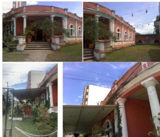
Ilustración 25. Estado actual de fachadas del inmueble
