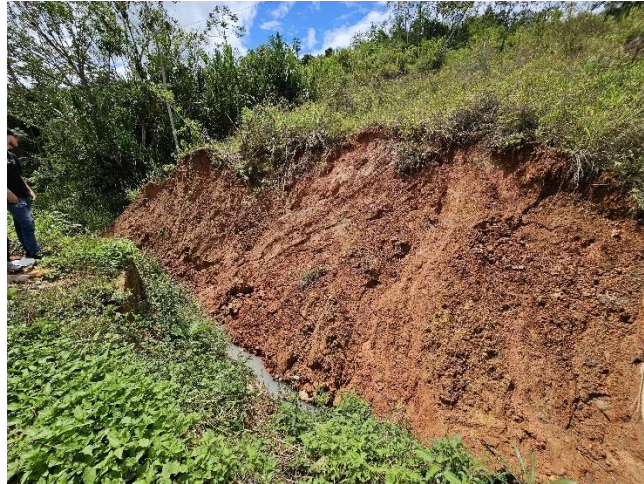
Figura 82: Condición de inestabilidad cauce Quebrada El Cafetero(3-nov2023)
