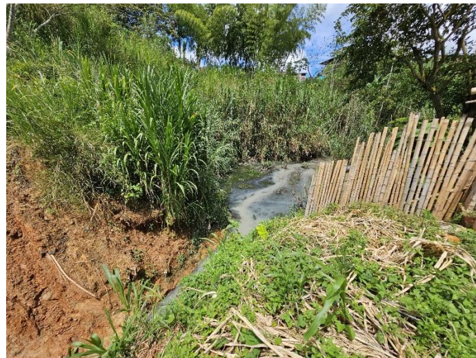
Figura 83: Condición de estanqueidad de la Quebrada El Cafetero (3-nov2023)
