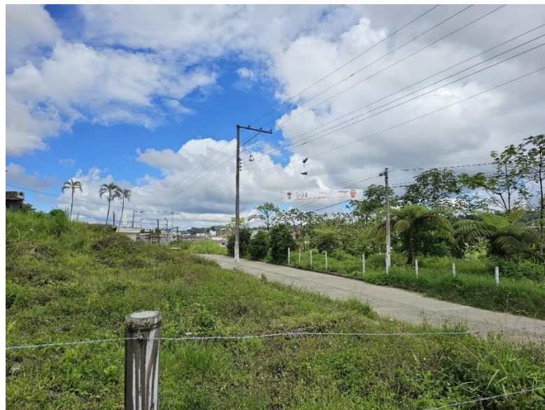
Figura 98: Elementos de red eléctrica existentes (noviembre 3 del 2023).
