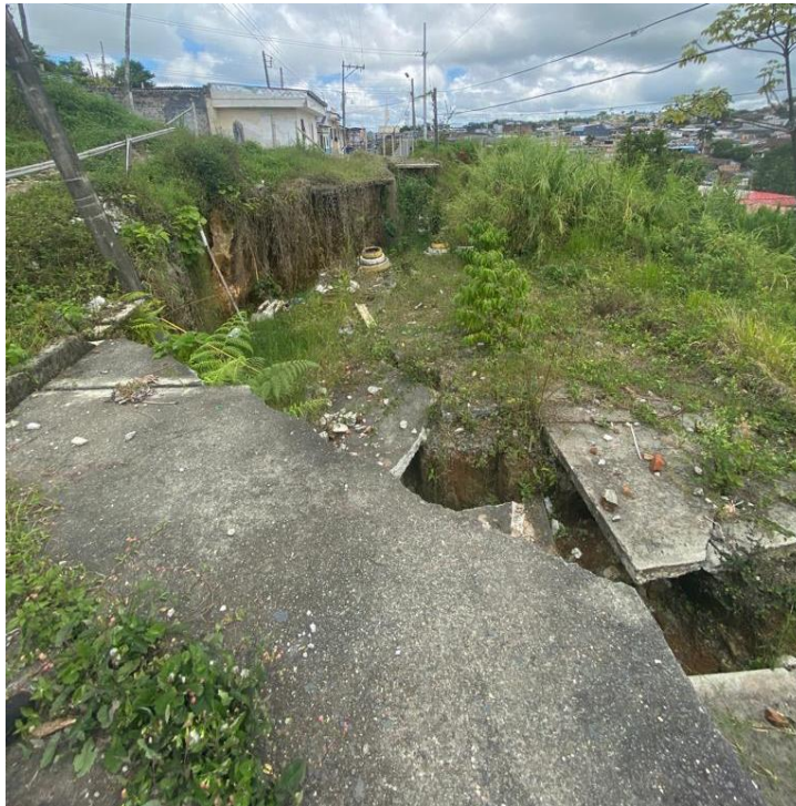
Figura 6: Estado actual carrera 51 (noviembre 3 del 2023).
