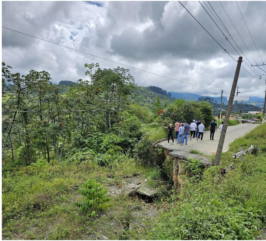
Figura 97: Vía existente, colapsada parcialmente (noviembre 3 del 2023).
