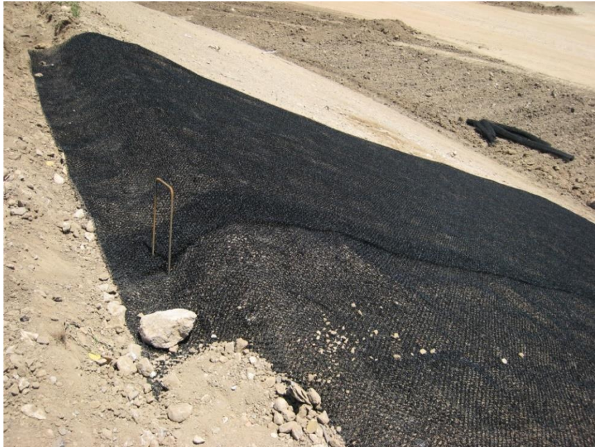
Figura 105: Geomalla instalada en un talud
