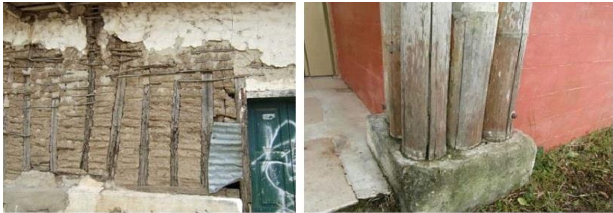
Figura 4 Daño por termitas y hongos en guadua
