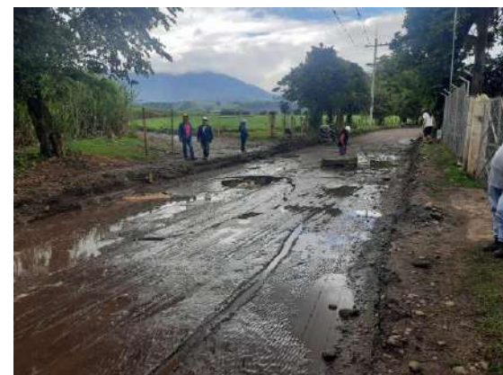
Hundimiento de Subrasante – (K0+300 a K0+370)
