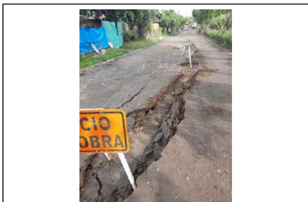
Grietas en Subrasante – (K0+300 a K0+370)
