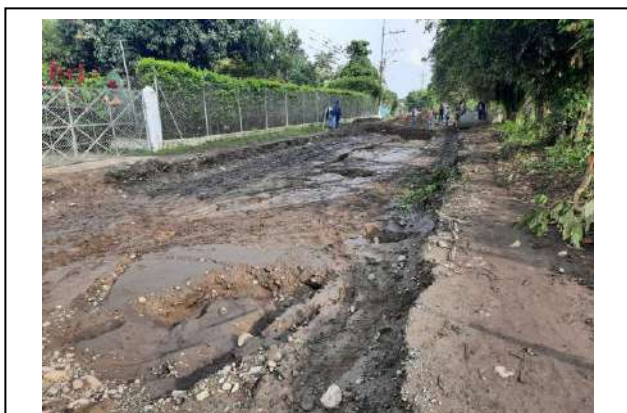
Cajeo en Zona de Hundimiento
