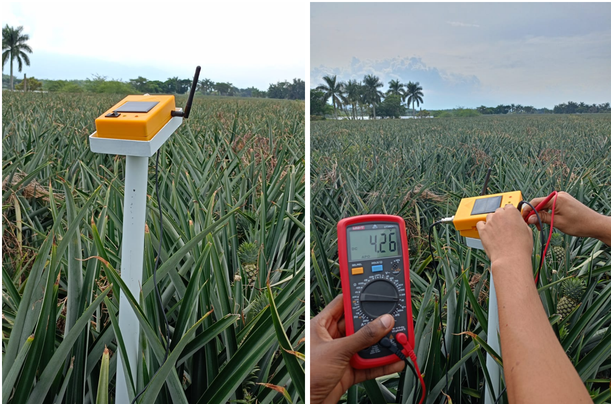
Figura 4.41: Pruebas de panel solar en ubicación final del nodo sensor.
