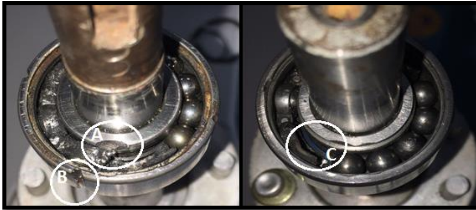
Figura 28. Fallas en rodamientos
