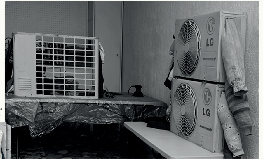
Figura 65. Condensadora y taller, Fotografía.
