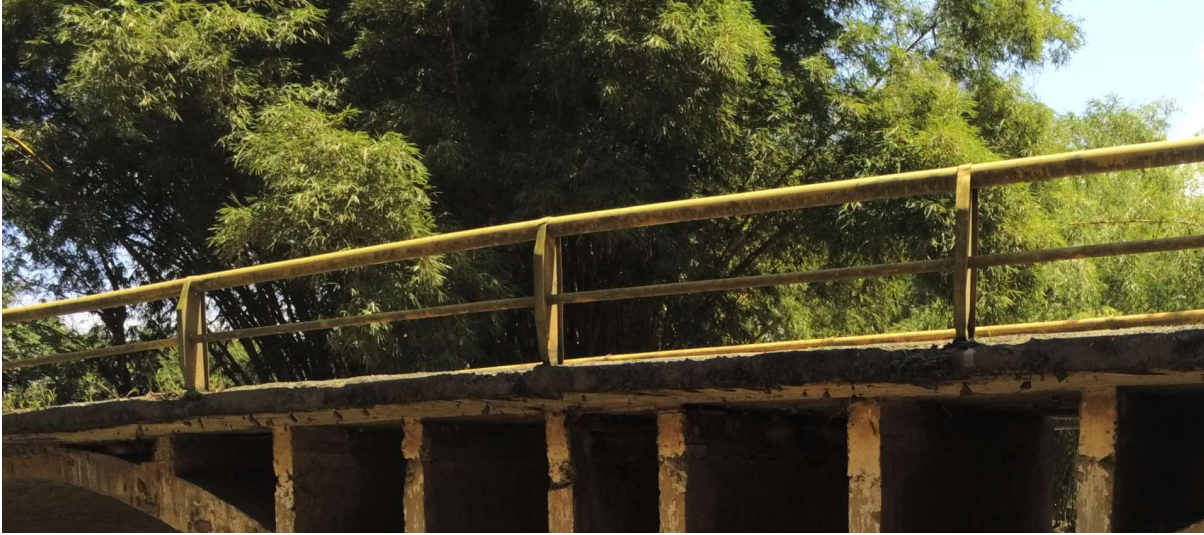
Fotografía No 10. Baranda metálica, Aguas Abajo.
