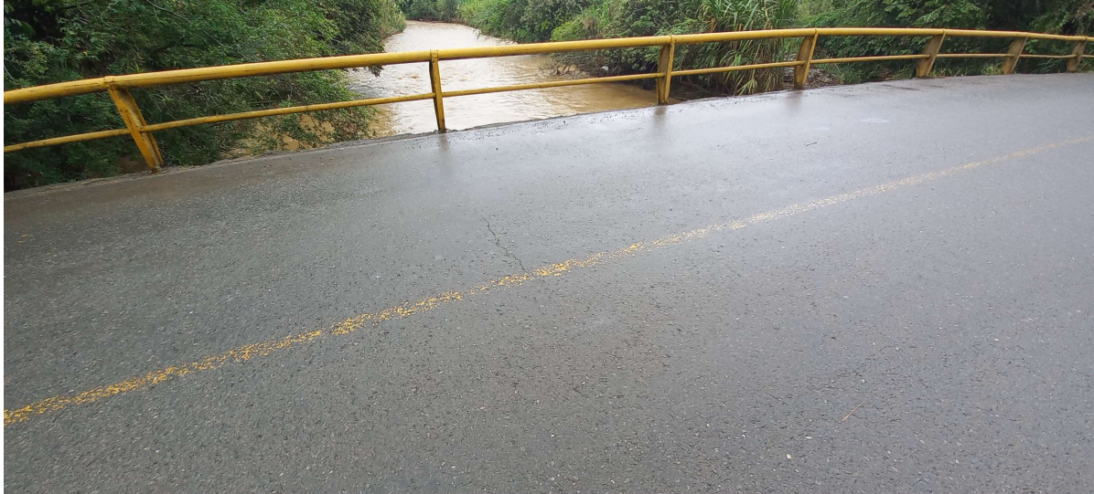
Fotografía No 11. Baranda metálica, Aguas Abajo
