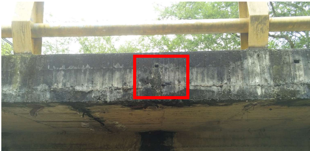
Fotografía No 6. Bordillo costado derecho
