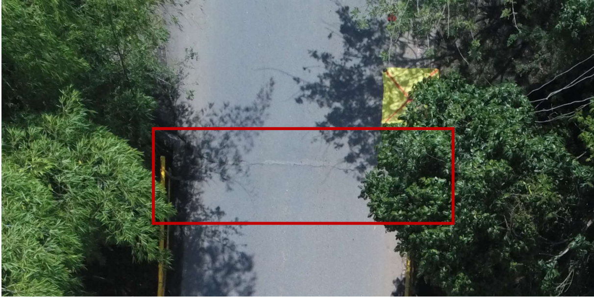
Fotografía No 6. Superficie del puente, fisura transversal en junta de construcción K0+000
