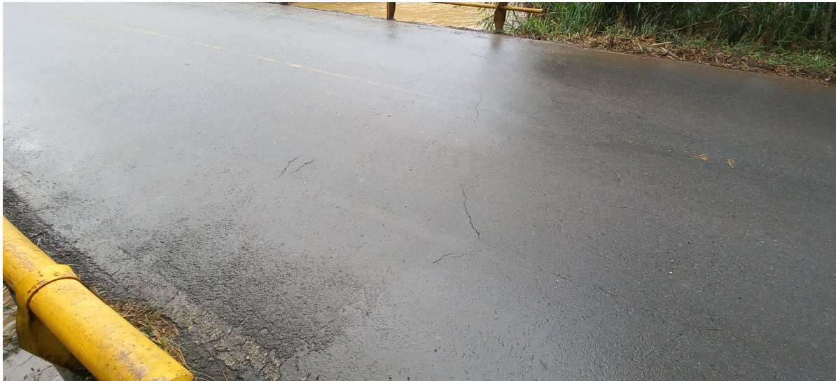
Fotografía No 8. Superficie del puente, fisura transversal en junta de construcción K0+028
