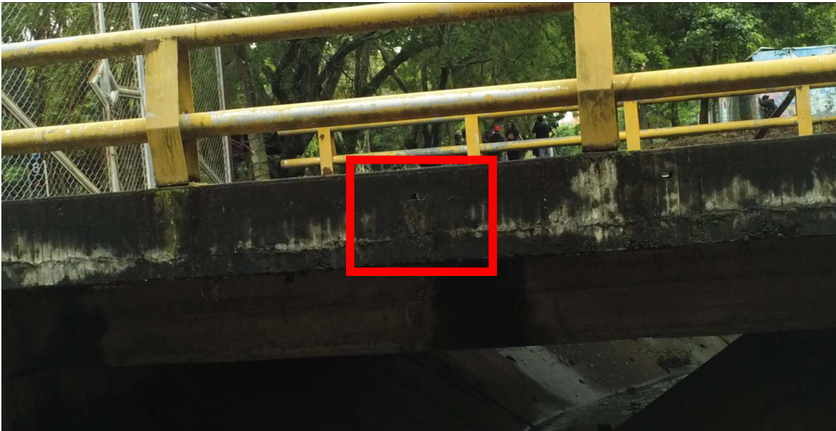
Fotografía No 6. Bordillo costado derecho
