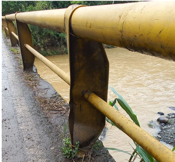
Fotografía No 12. Baranda metálica, Aguas Abajo
