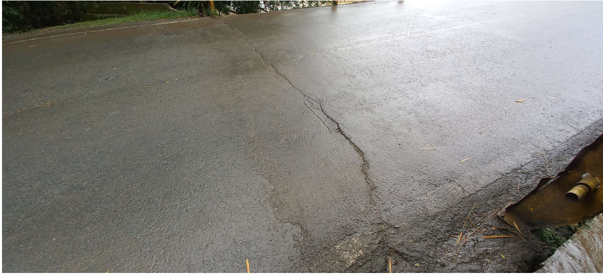
Fotografía No 7. Superficie del puente, fisura transversal en junta de construcción K0+000
