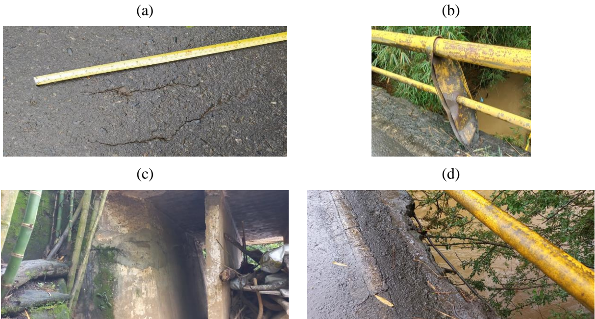
Figura 42 Patologías evidenciadas durante inspección visual tradicional. (a) Fisuración Transversal (b) Golpe por impacto vehicular (c) Grieta por Movimiento Lateral (d) Exposición del acero de refuerzo
