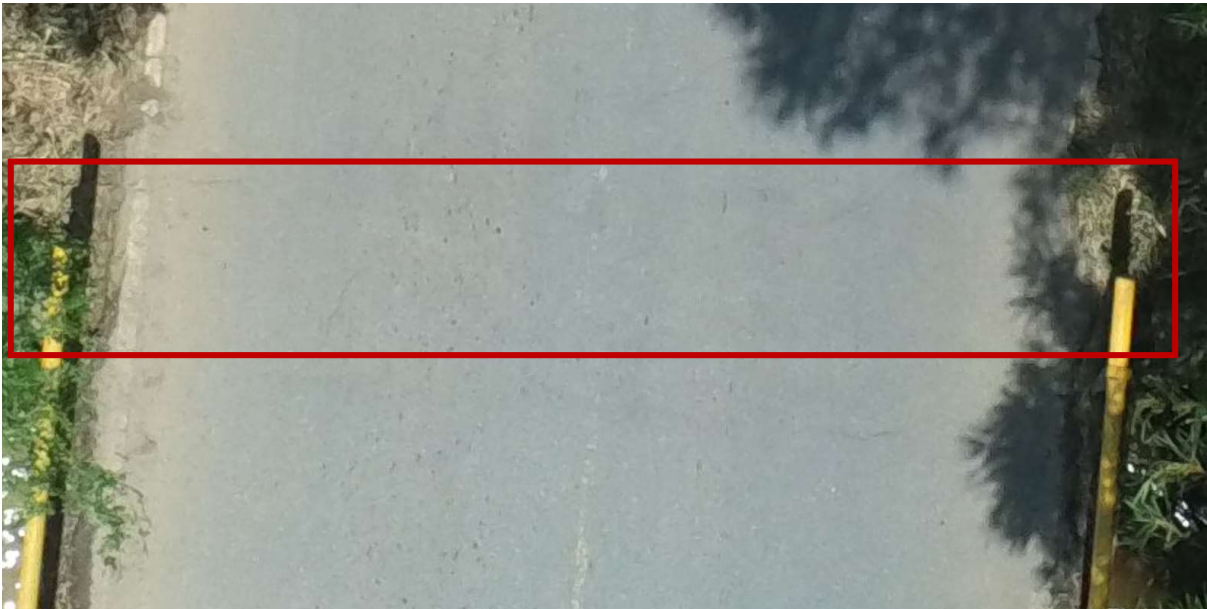
Fotografía No 7. Superficie del puente, fisura transversal en junta de construcción K0+028,5
