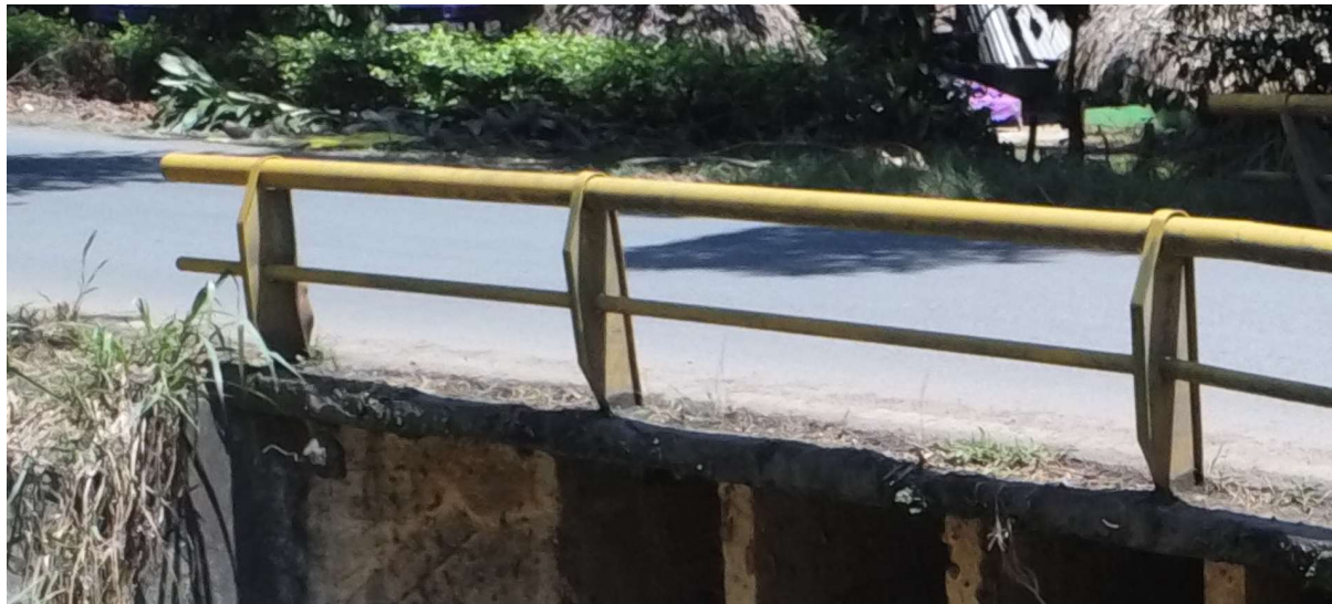
Fotografía No 11. Baranda metálica, Aguas Abajo.
