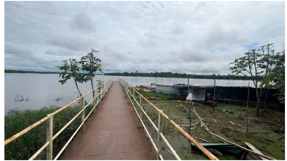
MALECÓN EN MAL ESTADO
