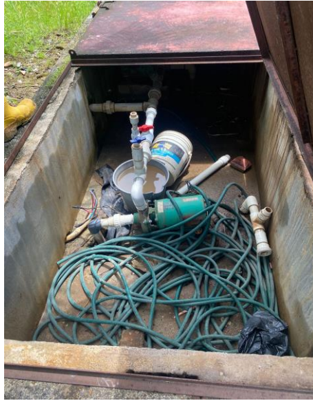
Figura 18 Bombas actuales (0,75hp)
