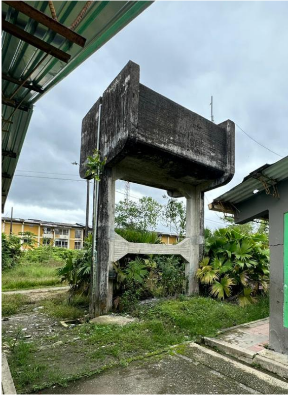
Figura 4 Tanque Distribuidor de agua en Concreto
