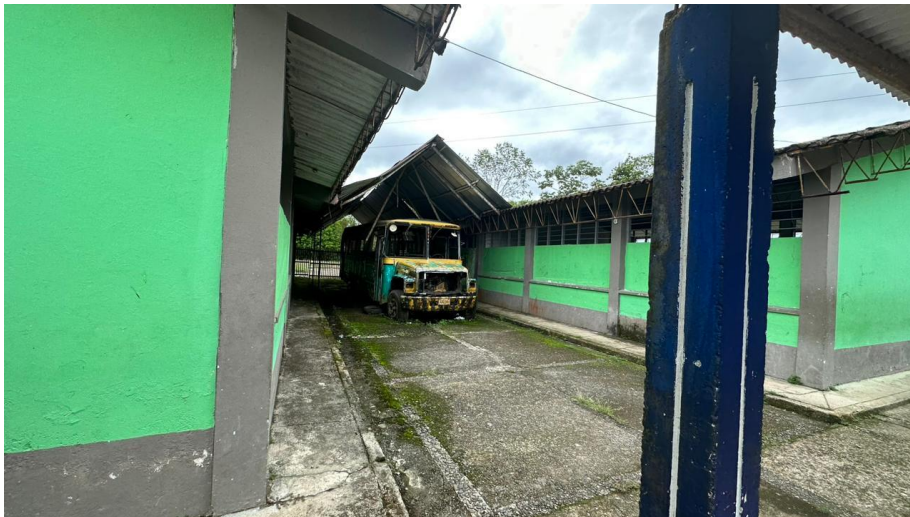
Figura 3 Instalaciones en deterioro
