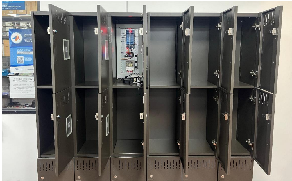
Figura 6.29: Casilleros - cableado finalizado.
