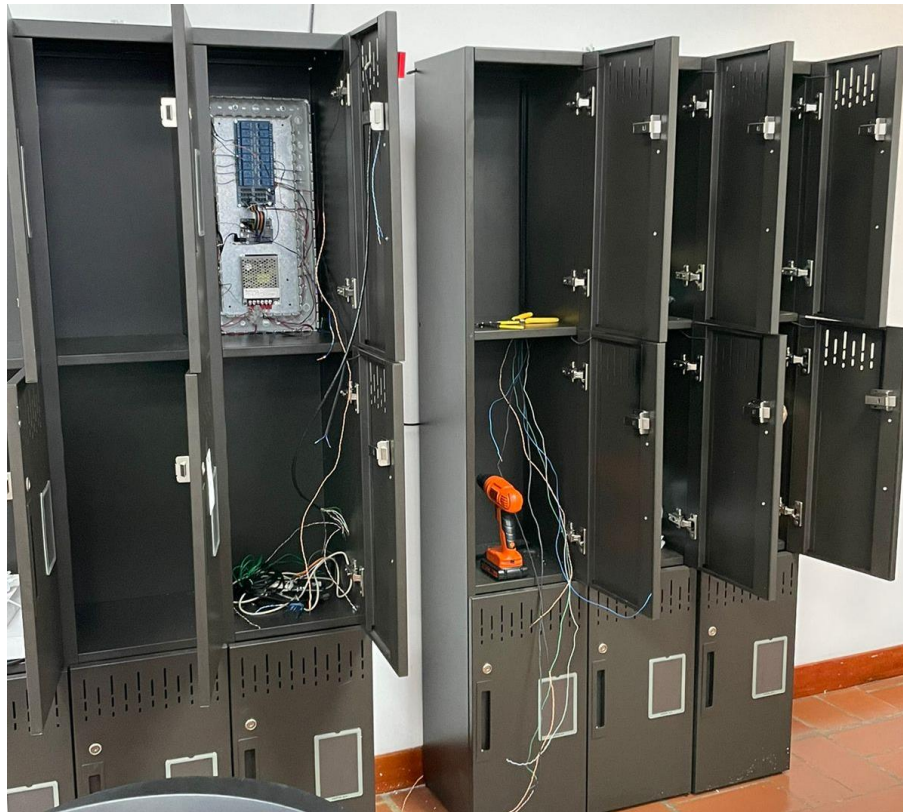
Figura 6.14: Despliegue de cableado en casilleros.
