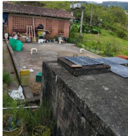
Figura 7. Tanque de almacenamiento
