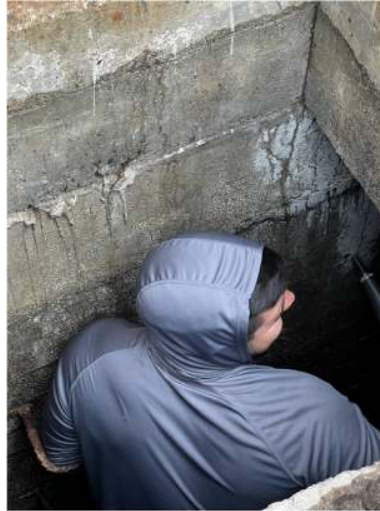
Figura 18. Estudiante bajando por la entrada de acceso del tanque de almacenamiento para llevar a cabo el ensayo del esclerómetro
