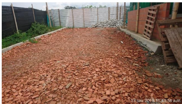
Figura 51. Uso de RCD provenientes de la zona de corte como material de lastre para mejorar el tránsito de volquetas.
