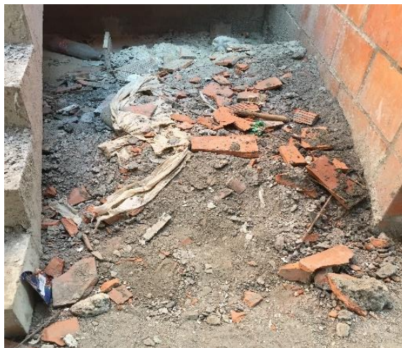
Figura 19. Acopio de residuos al interior de las unidades de vivienda.
