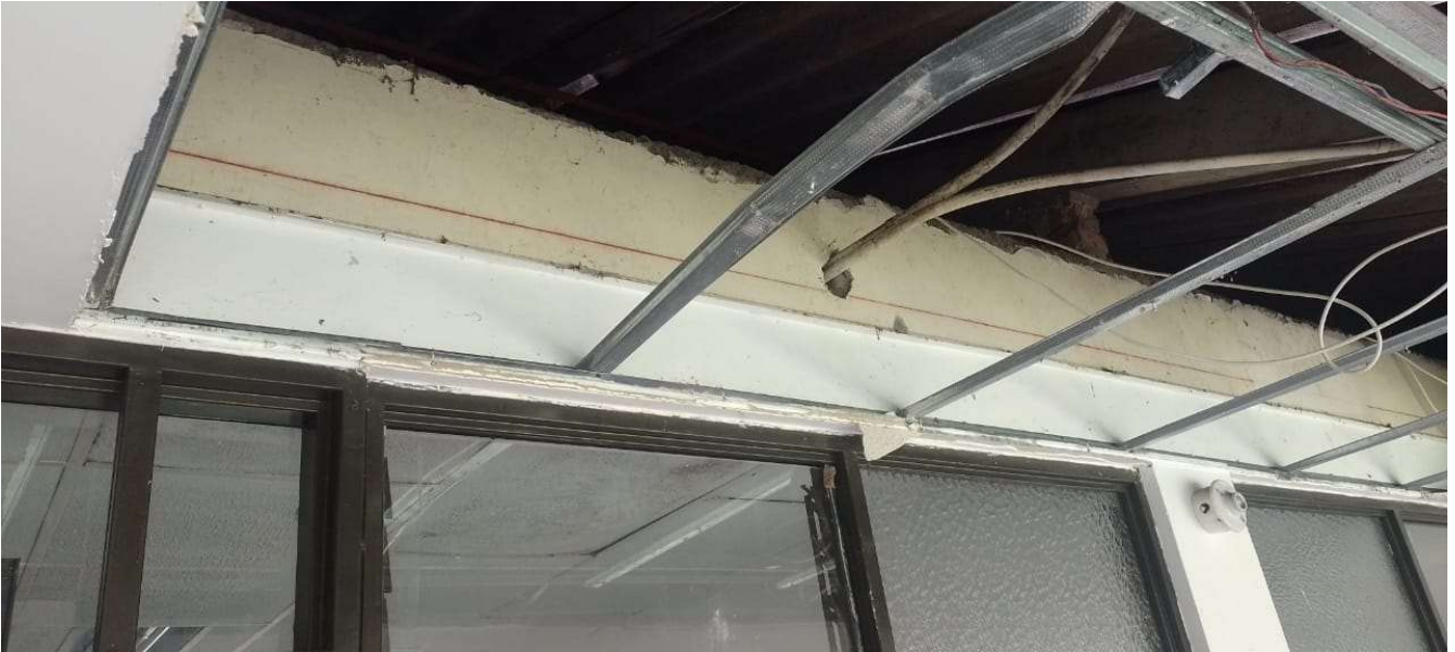
Imagen 2 - Estado actual cielo raso Zona Hospitalización, Hospital geriátrico san miguel.
