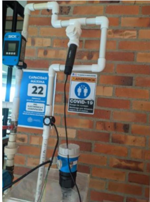
Figura 4.3. Instalación de sensor de pH y sensor de flujo en estación de flujo de agua
