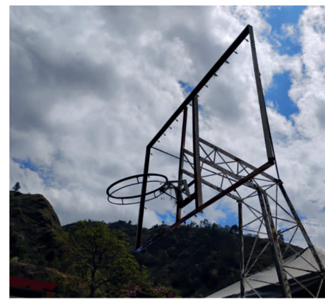
Cancha en deterioro.
