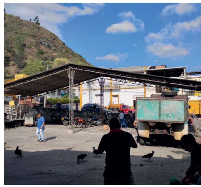
Cubierta en mal estado.
