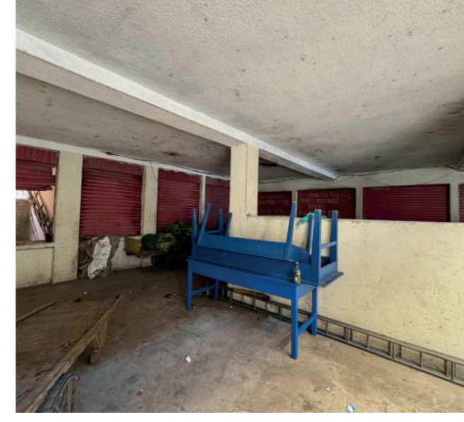
Locales con diseño inadecuado.
