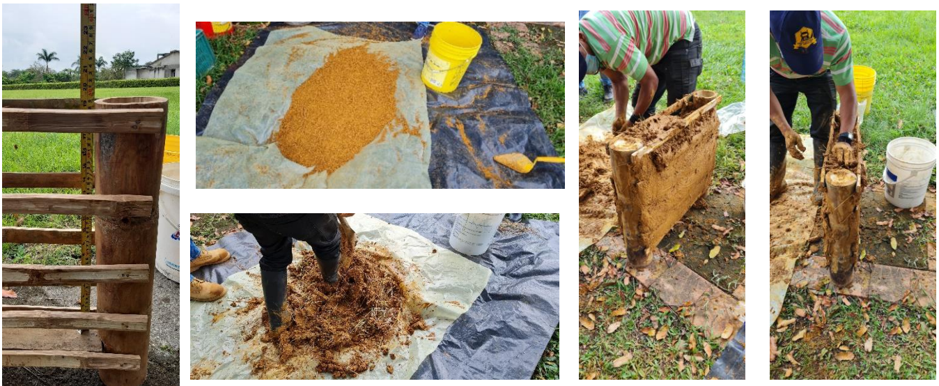
Figura 8 Construcción de un prototipo de muro en bahareque, por un residente de la zona
