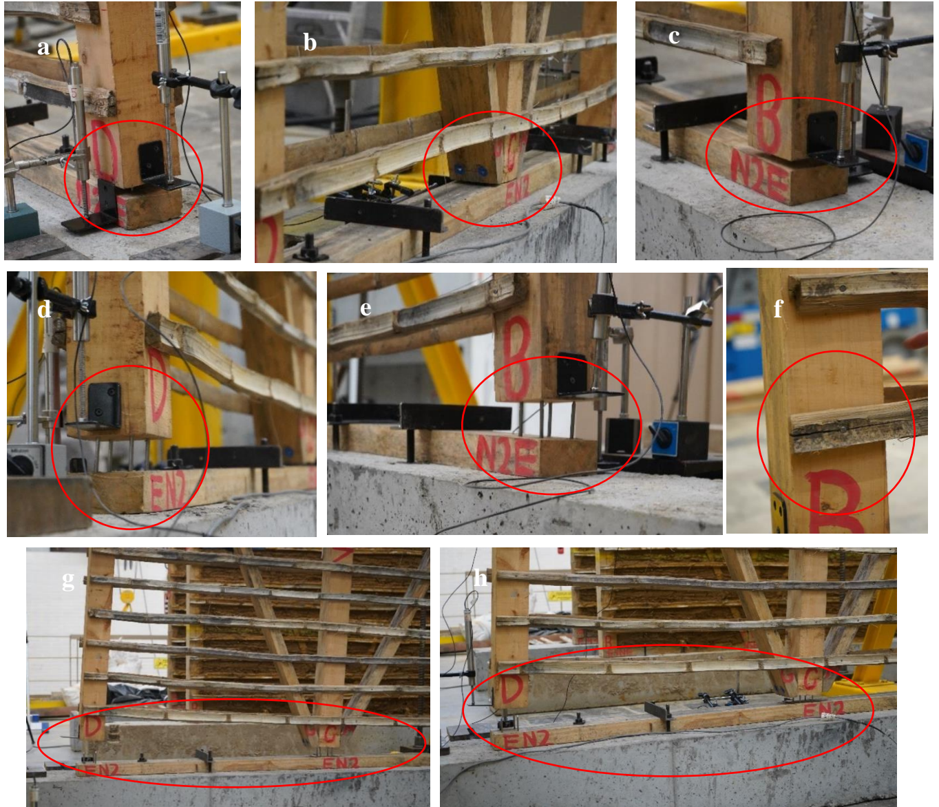
Figura 74 Fallas del muro TSH
