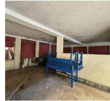
Locales con diseño inadecuado.
