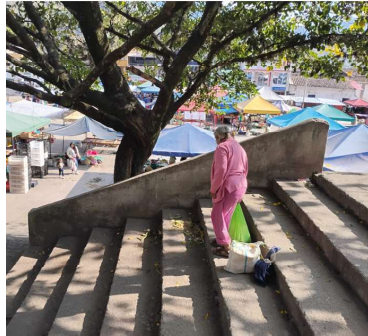
Falta de accesibilidad para personas discapacitadas.
