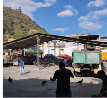
Cubierta en mal estado.
