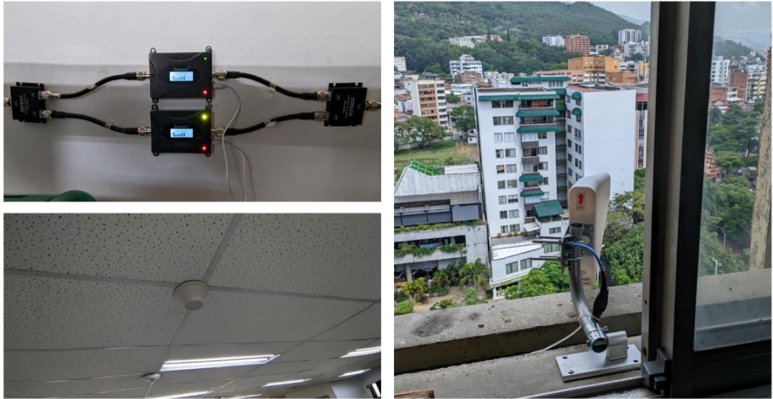
Figura 49. Instalación Final de los Equipos.
