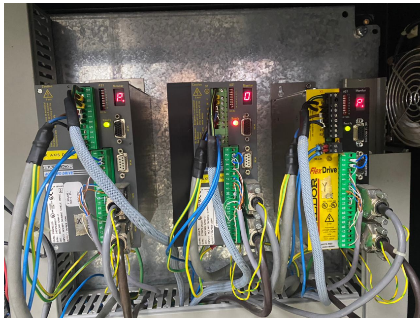
Figura 10.2: Daño en el controlador del eje Z del ASRS
