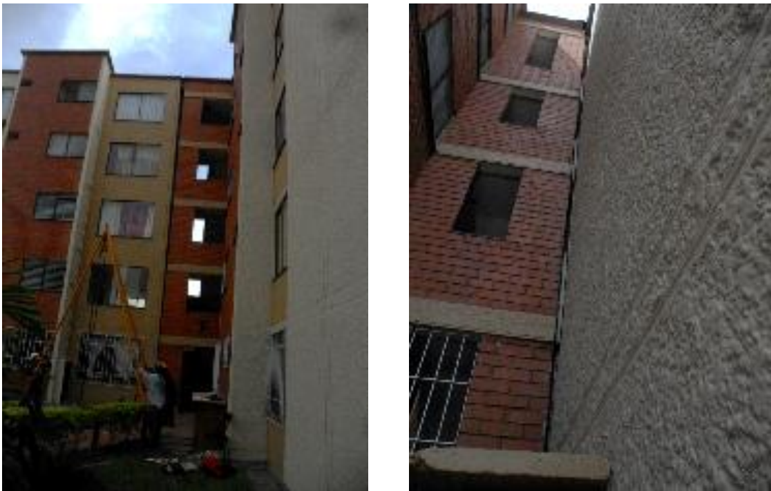
Figura 14. Dilataciones y desplomen entre bloques y puntos-fijos (Alma Ingeniería SAS, 2016).
