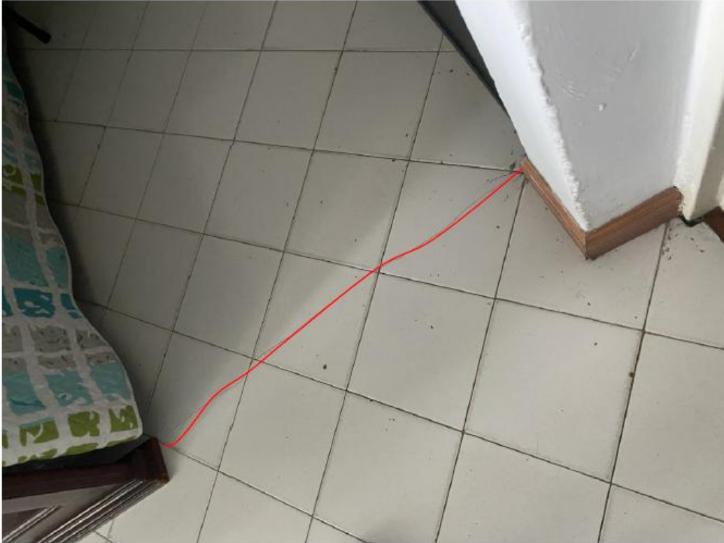
Figura 21. Evidencias de patología en el apartamento 102 F.
