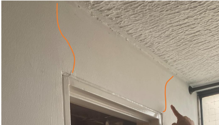
Figura 23. Evidencias de patologías en el apartamento 401 F.
