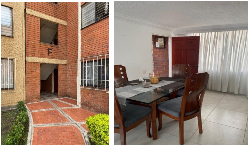
Figura 22. Evidencias de patología en el apartamento 103 F.
