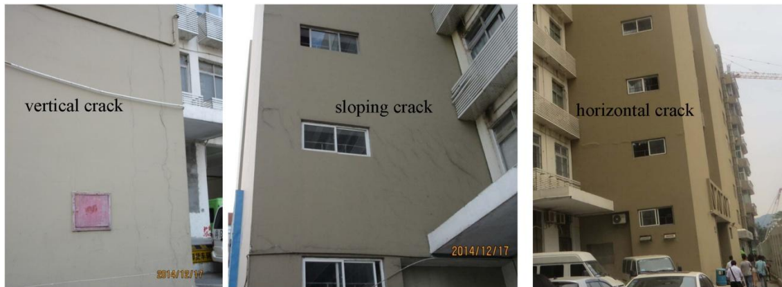
Figura 1. Daños típicos en los edificios adyacentes a la excavación profunda (Zhang et al., 2018).
