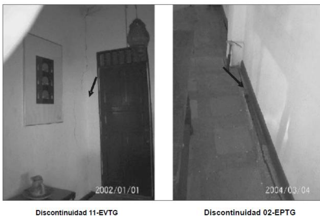
Figura 5. Daños asociados a los movimientos del terreno (Osorio y Sierra, 2008).
