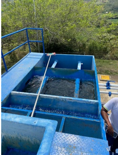
Ilustración 14. Filtros de la planta compacta
