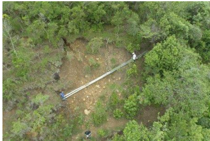
Ilustración 83. Tubería sobre talud en falla
