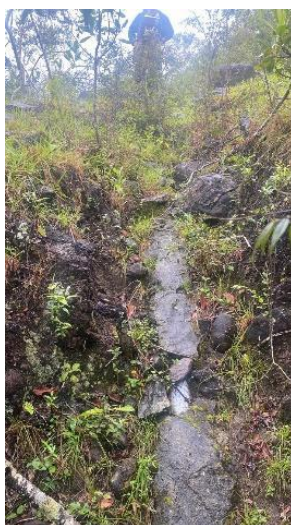
Ilustración 20. Perdida de recubrimiento de la tubería
