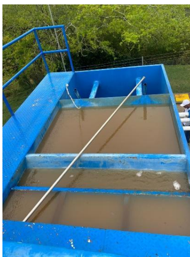
Ilustración 18. Filtros de la planta compacta cuando llueve
