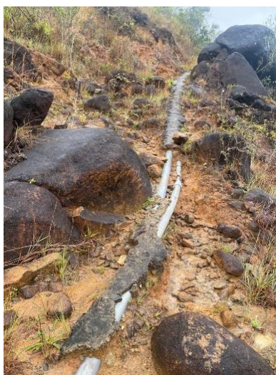
Ilustración 22. Tubería expuesta y en riesgo por deslizamiento de material
