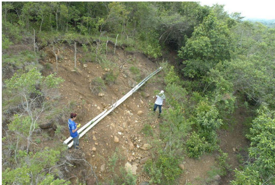
Ilustración 63. Tubería sobre talud en falla
