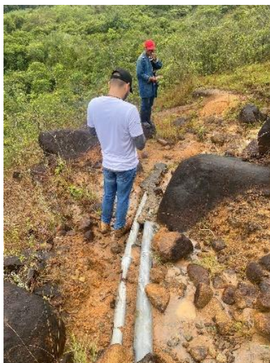
Ilustración 23. Tubería expuesta y en riesgo por deslizamiento de material
