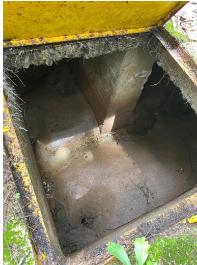
Ilustración 37 Interior desarenador quebrada Bitaco
