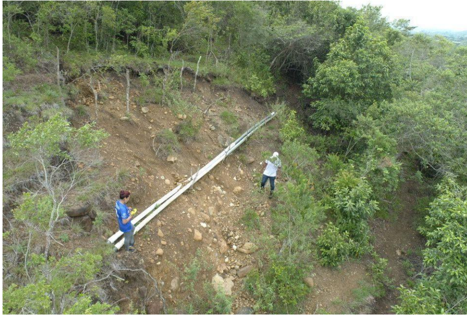
Ilustración 29 Fotografía de la falla de talud con el dron
