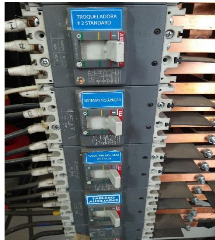
Fig. 9 Ejemplo de acometidas eléctricas de las máquinas
